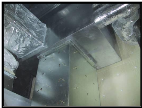
某高層ビル設置例
