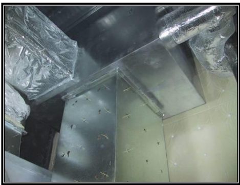
某高層ビル設置例
